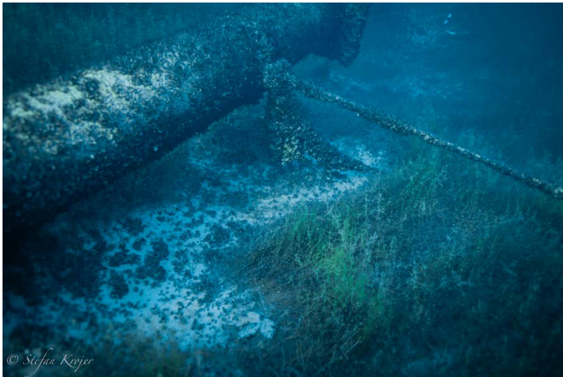
Abb. 4.2.: Foto: Attersee, Station Miesling – Die Seeleitung wird durch ein Seil in einer gekrümmten Bahn zum Seeboden geführt. Darunter sichtbar: freiliegender Seekreideboden mit Anzeichen von Unterspülung.
