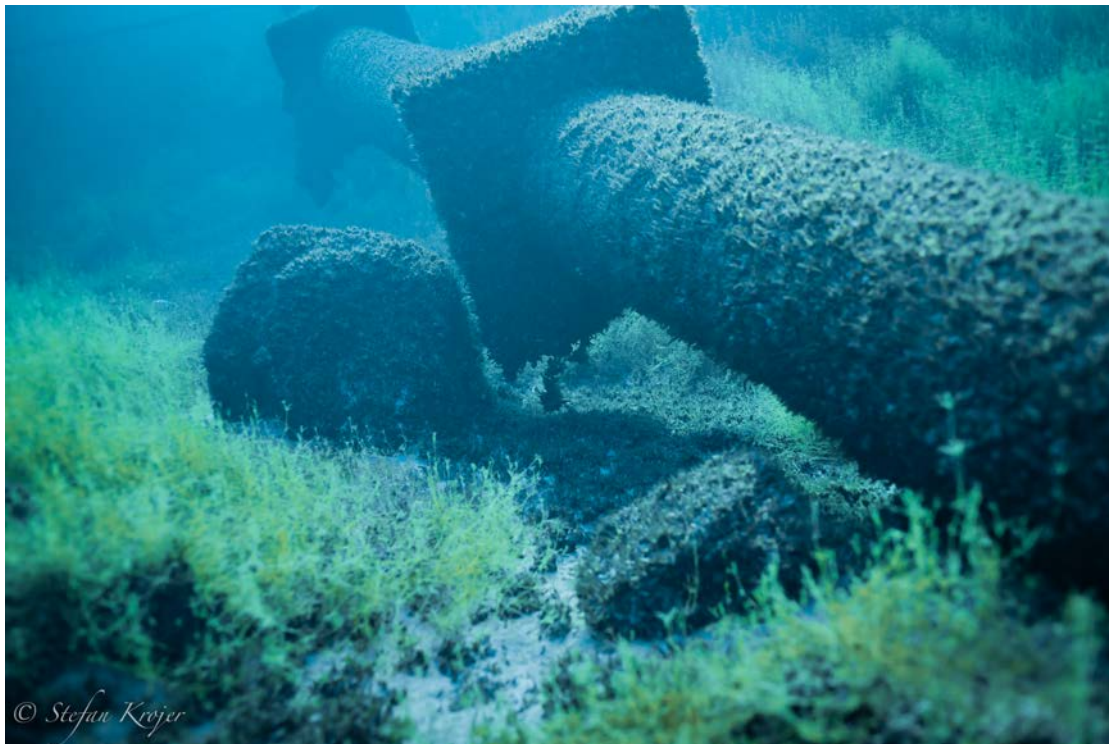
Abb. 4.3.: Foto: Attersee, Station Miesling – Die Seeleitung wird an einem ihrer Abtriebskörper durch einen Fels blockiert.
