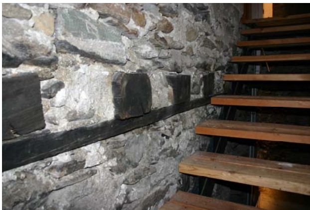
Abb. 34b: Winklern Mautturm, Durchtrennte historische Trägerbalken
