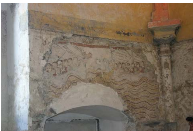
Abb. 48b: Krems, Gozzoburg, Amtskapelle, nach Abbruch des Gewölbes
