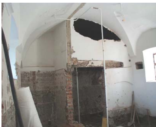
Abb. 14: Schloss Bruck, Esse: Verhinderter Mauerdurchbruch
