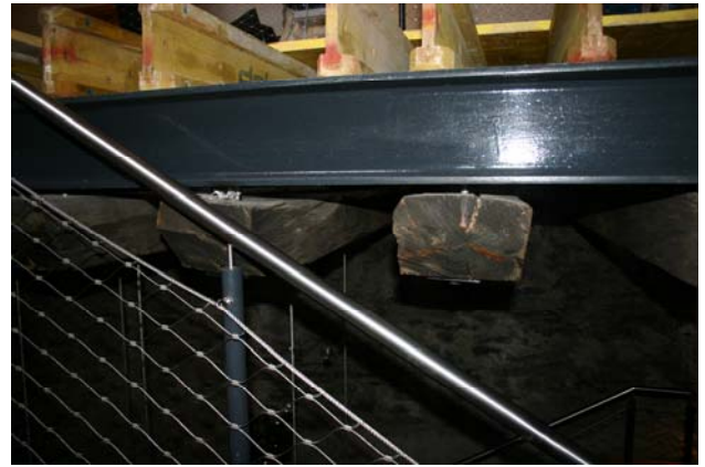
Abb. 34a: Winklern, Mautturm, Durchtrennte historische Trägerbalken
