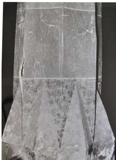
Abb. 135: Pfarrkirche Weistrach beschädigter Pfeiler (Foto Pfarrarchiv)
