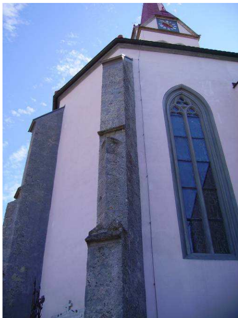
Abb. 15: Pfarrkirche Weistrach Strebepfeiler (Alfred Fischeneder 2010)
