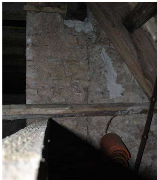
Abb. 122: Pfarrkirche Weistrach Dachboden Riss zwischen Turm und Chor (Alfred Fischeneder 2010)
