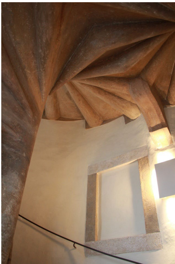
Abb. 28 Vermauertes Fenster im Erdgeschoss, Unterseite der Stufen an der Verschmelzung der Treppenläufe und Konsole.
