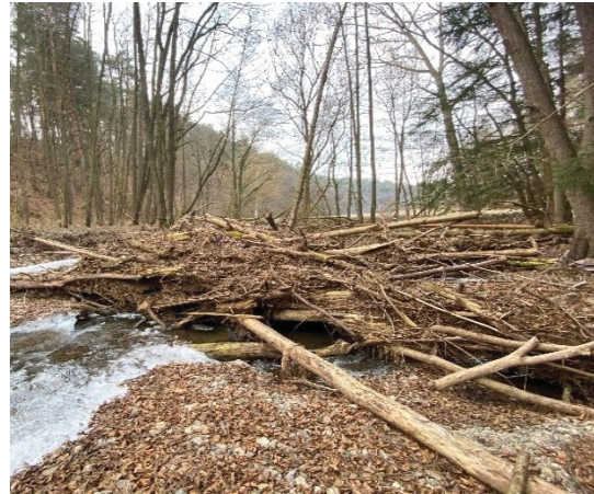
Abb. 8: Channel spanning jam: underflowing jam, flussabwärts (Quelle: eigene Aufnahme, 02.02.2025)
