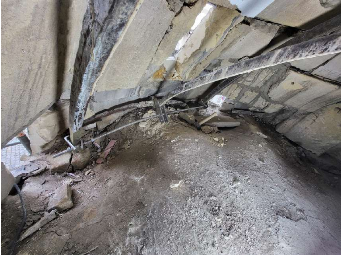
Abb. 96: Maria am Gestade. Eisenkonstruktion des Kuppelbaldachins über dem Westportal. (Bernleitner, Johannes (Fotograf), Fa. Ecker, Bestandsaufnahme. Wien, 2023. )
