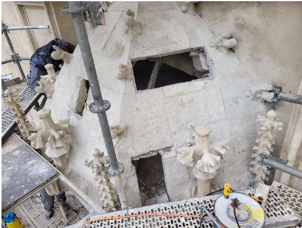
Abb. 65: Meister Michael, Maria am Gestade, 1394-1414, Wien, Eisenkonstruktion des Kuppelbaldachins über dem Westportal (Bernleitner, Johannes (Fotograf), Fa. Ecker, Bestandsaufnahme. Wien, 2023. )
