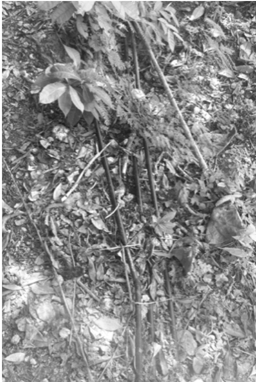
Abbildung 12 PVC-Schläuche, die an einer Stelle mit einem Isolierband geflickt wurden (Helmus 2020)
