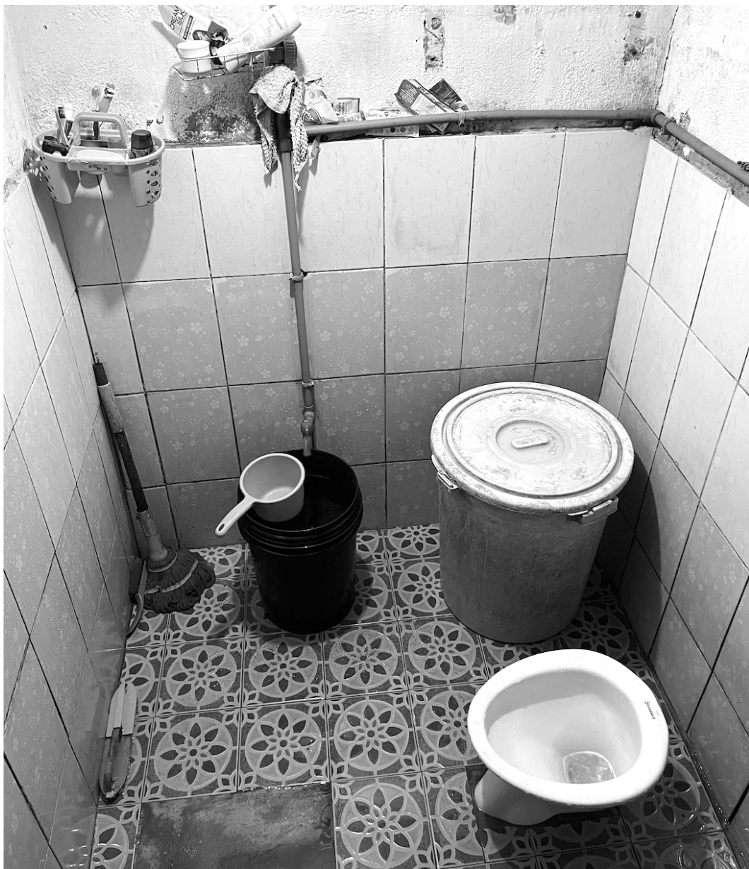
Abbildung 22 Einrichtung einer gewöhnlichen Toilette, der Tabo liegt im Baldi. Der größere Eimer dient als Wasservorrat, sollte es zu einem Wasserausfall kommen. Toilettenpapier ist nicht vorhanden. (Helmus 2022)
