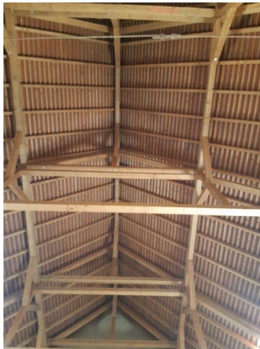
Abb. 88: Eggenburg, Pfarrkirche, westlicher Emporenanbau, Dachstuhl aus dem 21. Jahrhundert.
