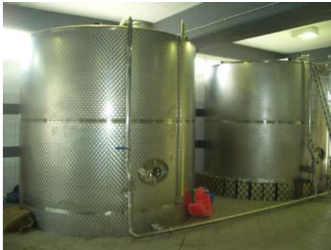
Abbildung 27: Lagerung in Edelstahlfässern
