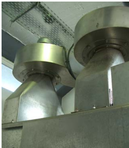
Abbildung 18: Turbinen zur Entfernung von Blättern
