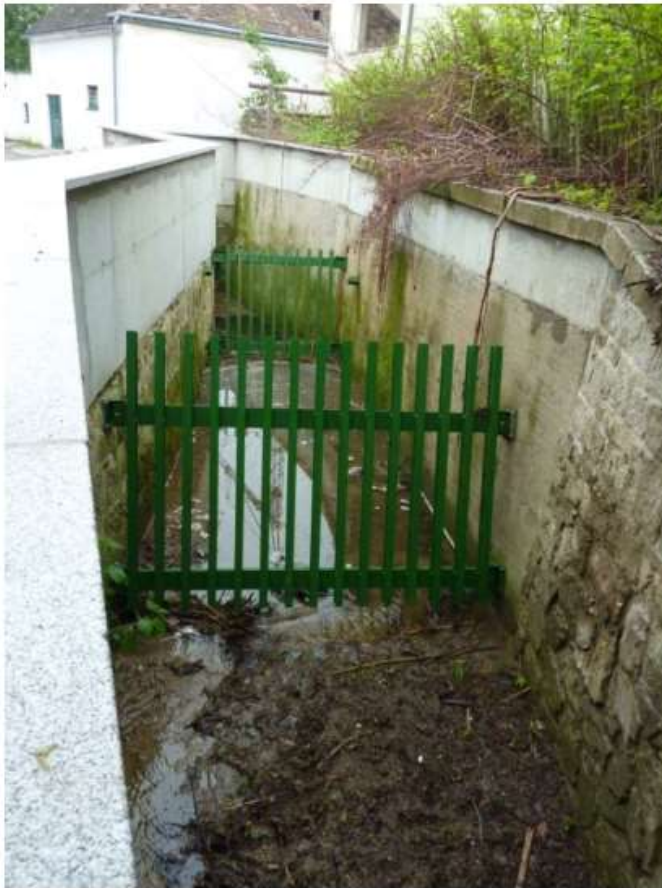
Abbildung 33: Einlaufbauwerk und Rechenanlage am Reisenbergbach (Quelle: Stadtrechnungshof Wien, 2014)
