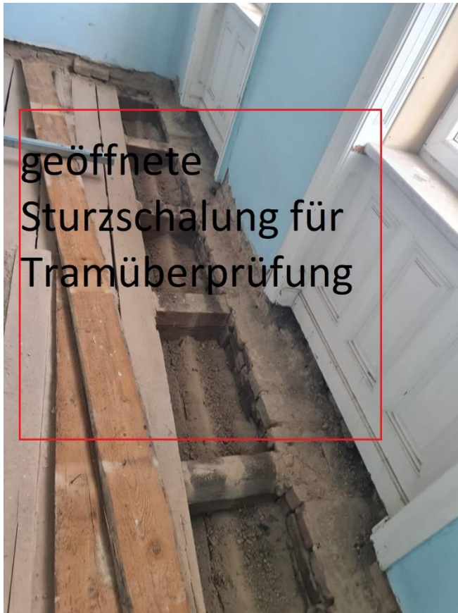
Abbildung 10 Geöffnete Tramdecke zur Auflagerprüfung
