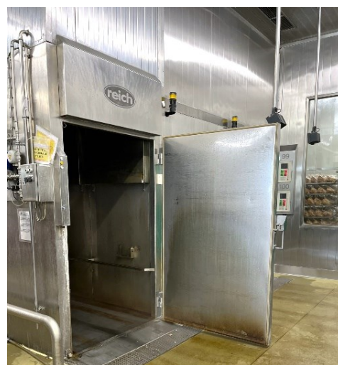
Abbildung 17: Kochanlage in der Selcherei
