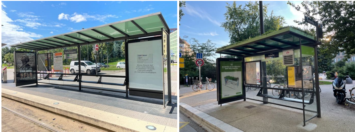
Abbildung 5-3: Wartehalle mit begrüntem Dach ist links an der Konstruktion verstärkt
