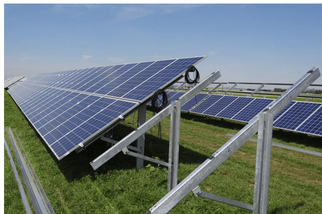
Abb. 4: PV-FFA in Reihenaufstellung (Quelle: Memodo 2021)
