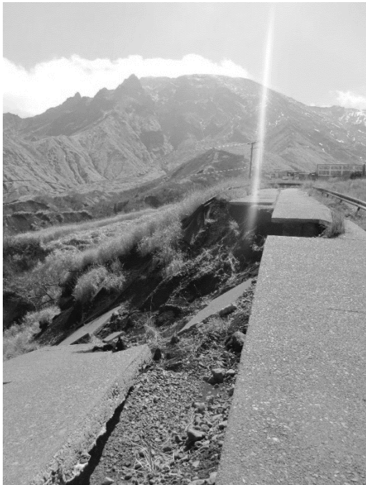
Abb. 15: Erdbebenschäden nahe Sensuikyō 仙酔峡 in Aso-shi (März 2018, eigene Fotografie)
