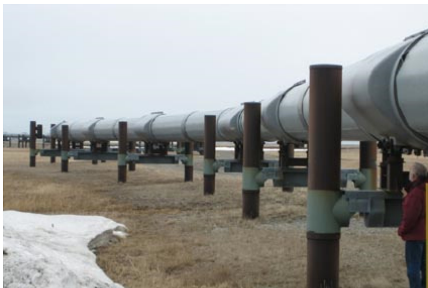
Zdjęcie 5. Rurociąg nadziemny
