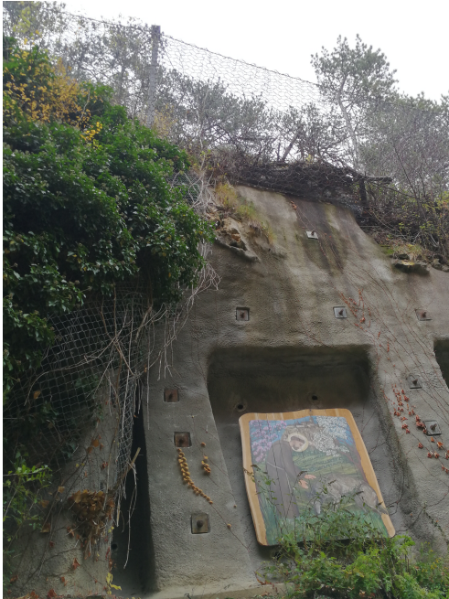
(a) Felsverankerung und Spritzbetonschale in Pitten, Niederösterreich. Das Steinschlagschutznetz darauf schützt vor Steinschlag von einem weiter oben liegenden Hang.
