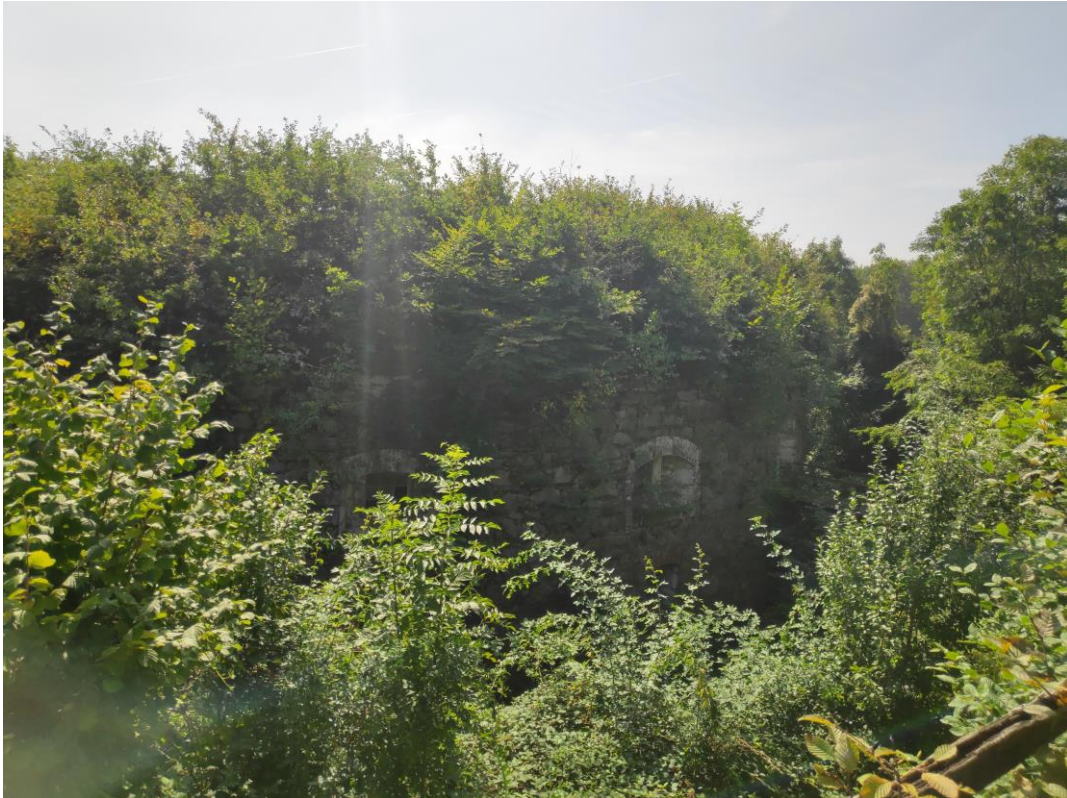
Abbildung 15: Turm 20 – starker Bewuchs 465
