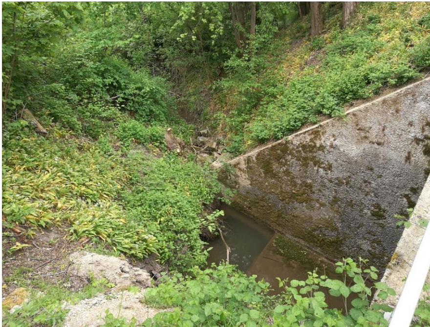
Abbildung 12 - Rutschung St. Pantaleon-Erla - Damm und Bach am Fuße der Rutschung - eigene Aufnahme
