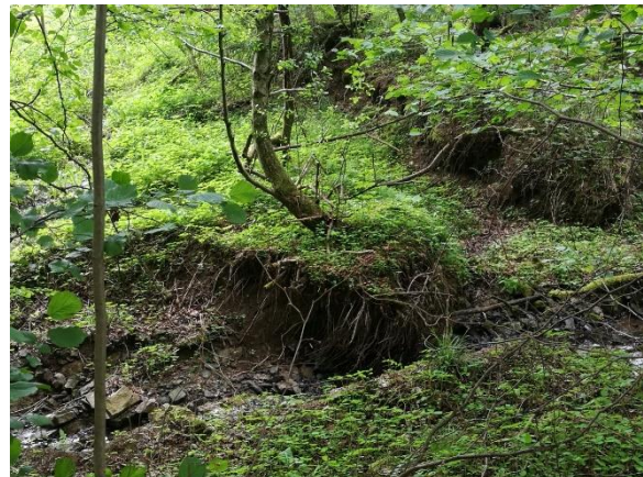
Abbildung 14 - Rutschung Behamberg – unterer Bereich der Rutschung - eigene Aufnahme
