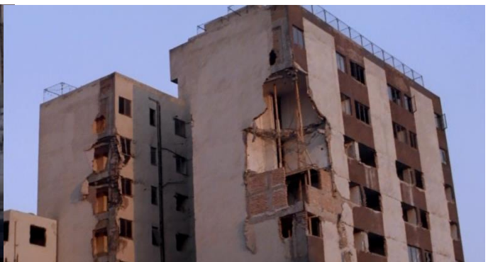
Abb. 25 Schäden durch das Erdbeben 1985 (Lola 1989, TC 01:05:05)
