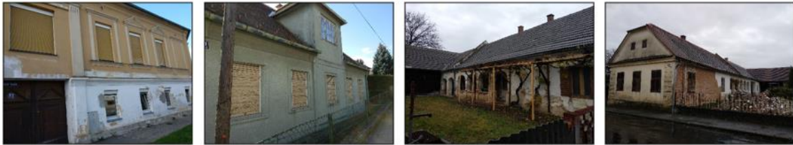
Abbildung 23: Baufällige Leerstände Untersuchungsgebiet B (Foto: Kirisits Laura)
