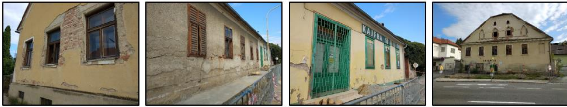
Abbildung 20: Baufällige Leerstände Untersuchungsgebiet A (Foto: Kirisits Laura)
