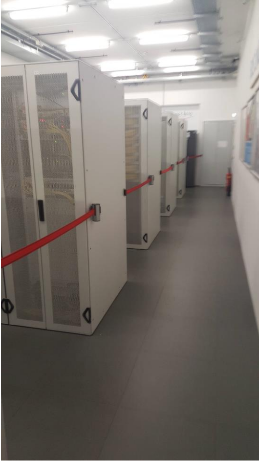
Abb. 33: Der Serverraum im Überblick
