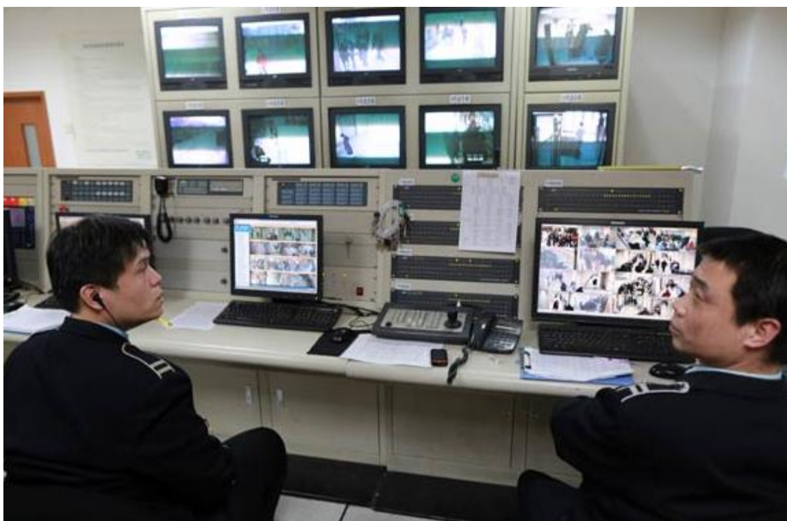
Abb. 27: Die neue Kommandozentrale des Universitätsklinikums Peking
