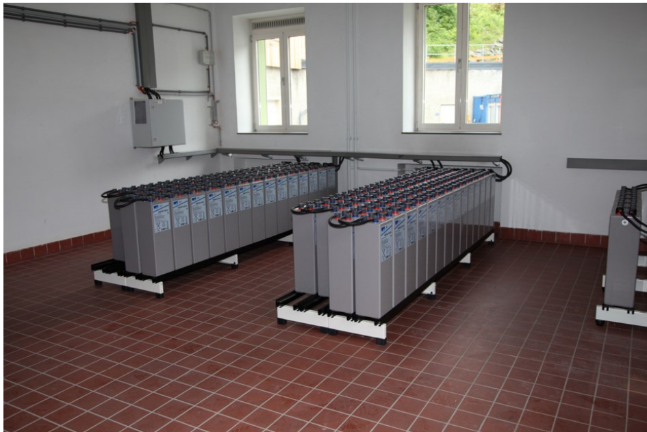
Abb. 41: Stützbatterien im Krafthaus Uttendorf
