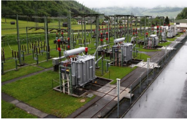
Abb. 40a: Bahnstromtransformatoren im Kraftwerk Uttendorf
