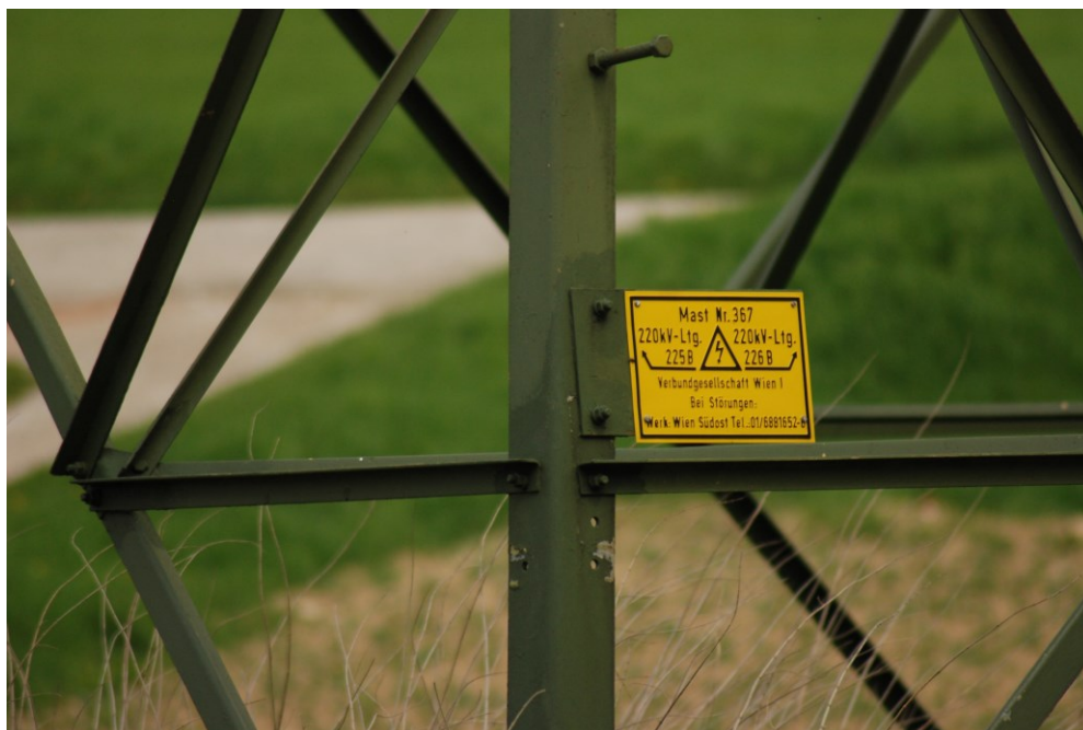
Abb. 38: Mastfußkennzeichnung im öffentlichen Netz
