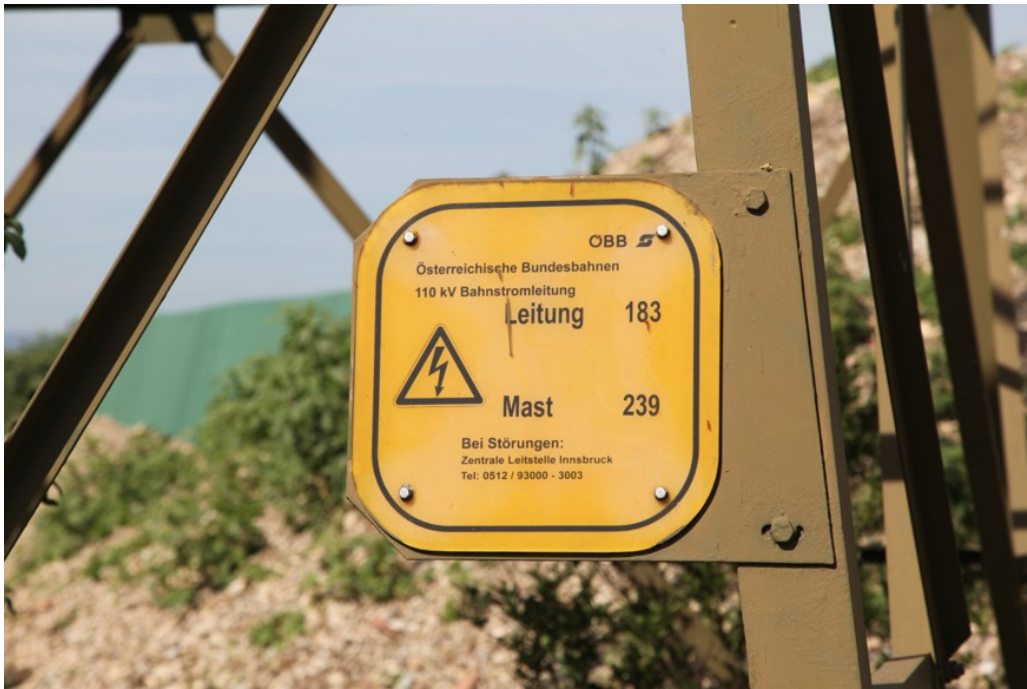
Abb. 39: Mastfußkennzeichnung im ÖBB-Netz
