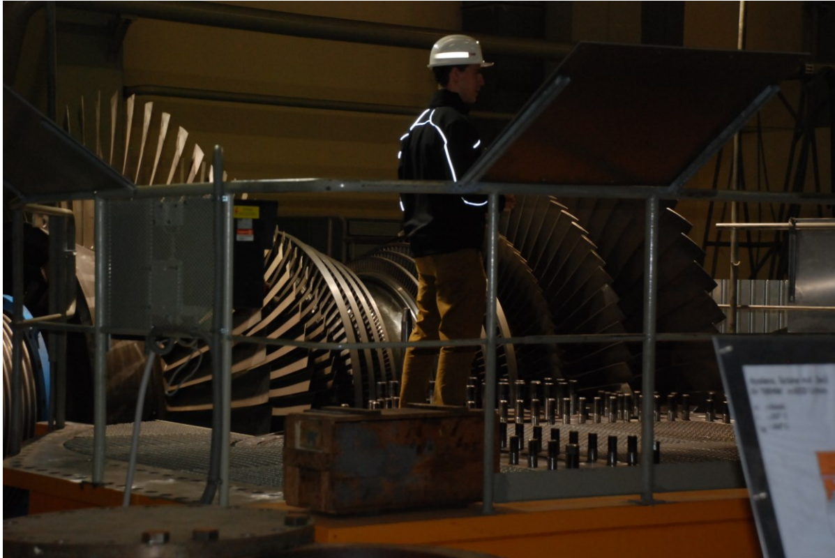
Abb. 22: Dampfturbine des KKW Zwentendorf
