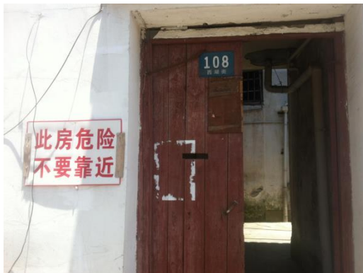
Abb. 11: Einsturzgefährdetes Gebäude („Das Gebäude ist gefährlich. Nicht näherkommen!“) 108
