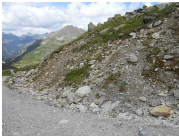
Abbildung 58: Böschungsrutschung am Wegesrand (Aufnahme: Guttman 2016)
