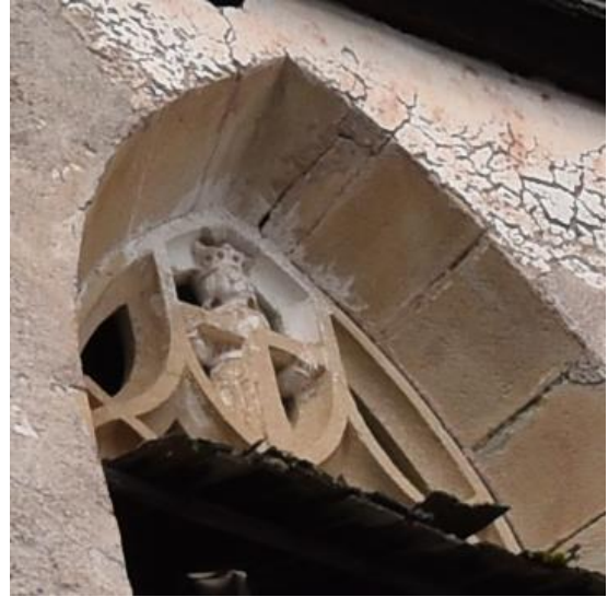
Abb. 8: Detail, Maßwerkfenster, Südseite, Kirchturm, St. Helena in Deutschnofen.
