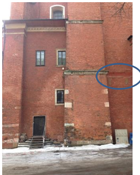
Abb. 63. Nordwand der SS. Peter und Paul Kirche, Stützpfiler beim Eingang in die Sakristei und Spuren der früheren Gänge in der Wand des Transepts.
