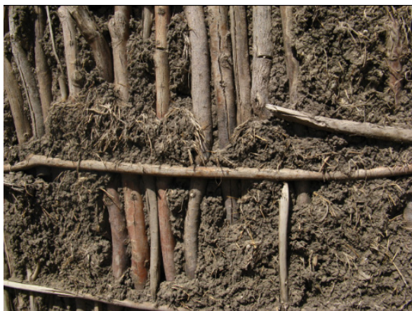
Abb. 57 Vom Regen abgewaschener Lehmverputz an der Außenwand eines chikka -Hauses
