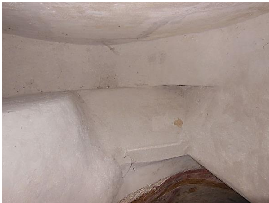
Abb. 4: Störung der Deckenkonstruktion bei heutigem West-Eingang zur Burgkapelle, Burg Ottenstein, vor 1177, Österreich, Rastendorf (NÖ).
