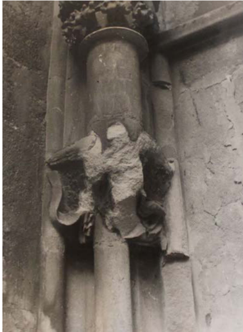
Abbildung 40: St. Stephan, Chor, Beschädigte Konsolenfigur 1945.
