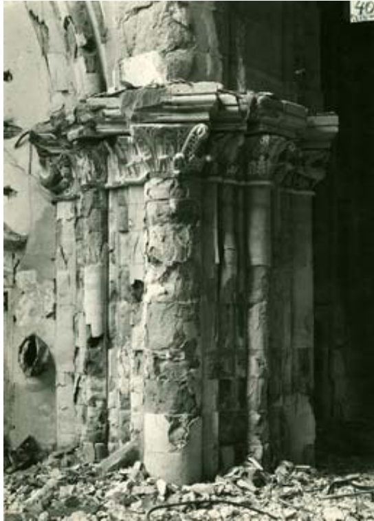
Abbildung 48: St. Stephan, Westempore, Absprengungen am Pfeiler.
