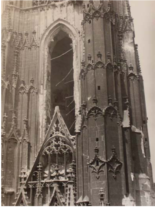
Abbildung 20: St. Stephan, Südturm, Schäden am Ostfenster 1945.
