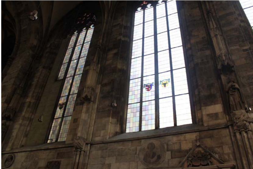
Abbildung 50: St. Stephan, Rotfärbungen im Frauenchor, Zustand 2013.
