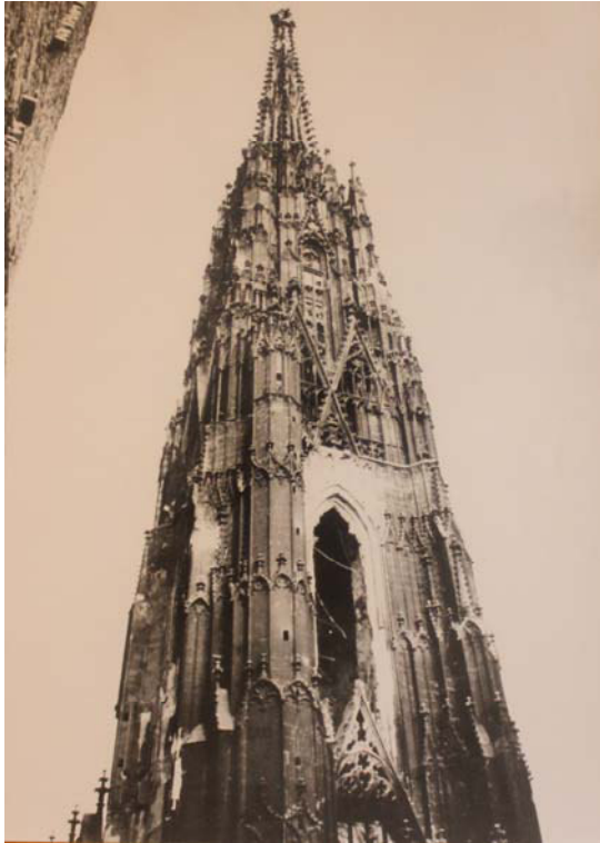
Abbildung 18: St. Stephan, Schäden am Südturmfenster 1945.
