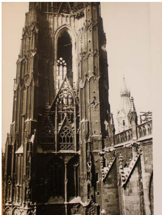
Abbildung 21: St. Stephan, Südturm, Schäden am Ostfenster 1945.
