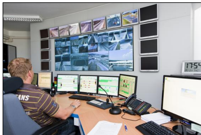
Foto 13: Überwachungszentrale (Quelle: Bonaventura Straßenerrichtungs-GmbH 2010g)
