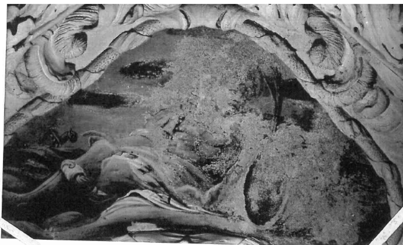
Abb. 182: 60 Zustand vor Restaurierung.
