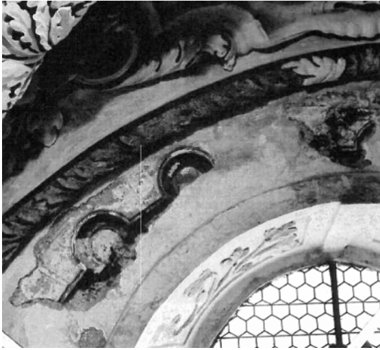
Abb. 19: Baumgartenberg, Stiftskirche, Querschiff, teilweise freigelegtes romantisches Bogenfries.
