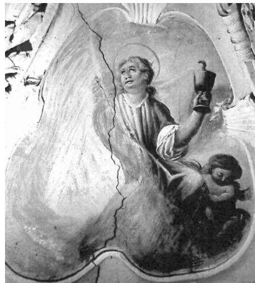
Abb. 185: 62 Zustand vor Restaurierung.
