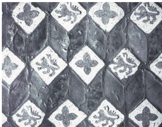
Abb. 23: mörtelinkrustierte Fliesen aus Lüneburg (D)
