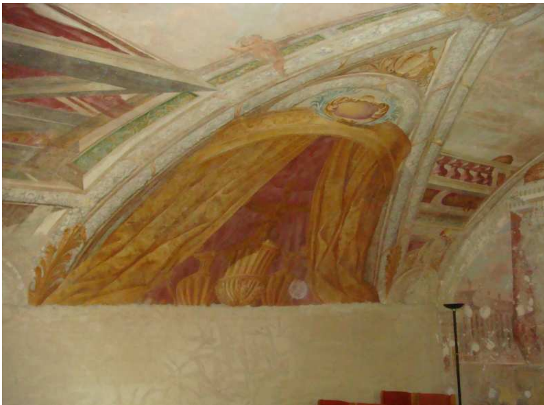
Abb.28: Schloss Vösendorf, Sala terrena, Fehlstelle an der Ostwand.
