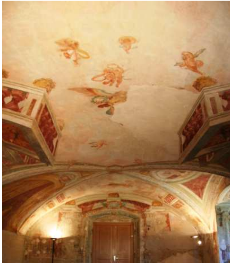
Abb.25: Schloss Vösendorf, Sala terrena, Gewölbespiegel mit Fehlstelle.
