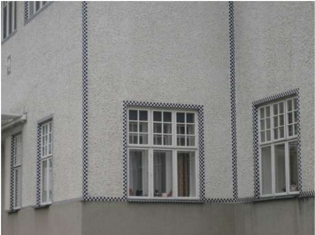
Abb. 101 Josef Hoffmann, Sanatorium Purkersdorf, 1904-1905, Ostfassade, Fliesenbänder an den Gebäudekanten, Zustand 2012.
