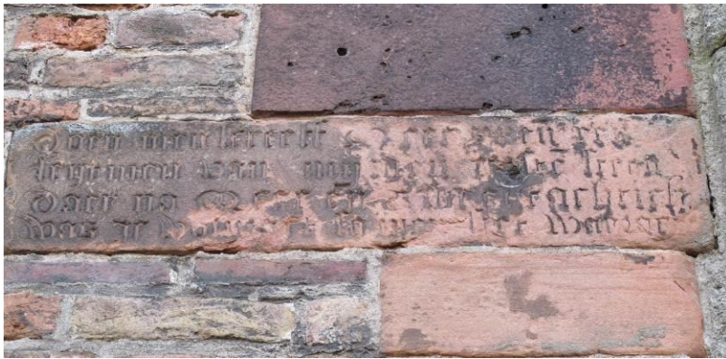
Abb. 22: Inschrift an der Westwand des Domturmes
