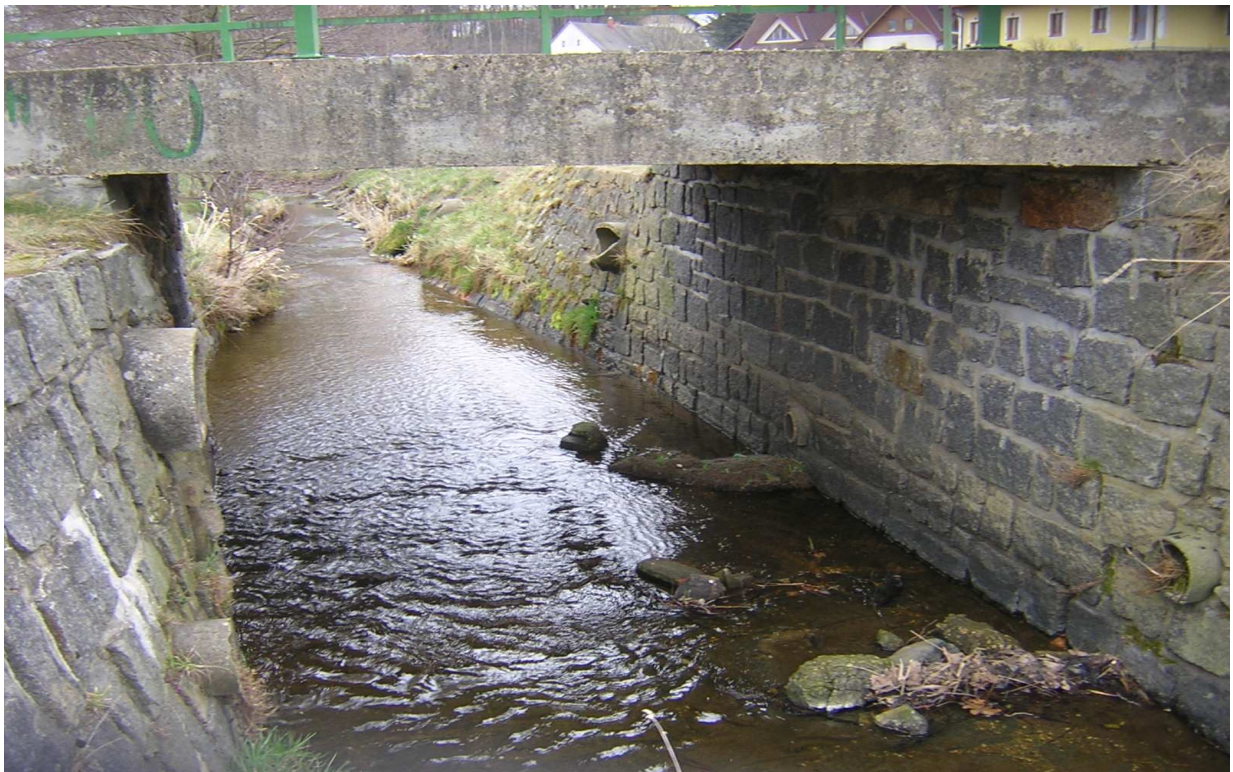
Abb. 7: Brücke für den Fischotter zum Markieren mehr oder weniger geeignet
