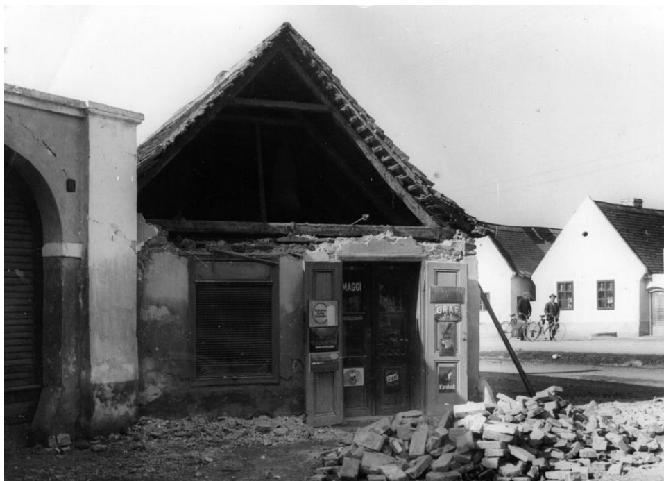
Abbildung 4: Aufnahme der Auswirkungen des Schwadorf Bebens von 1927 (Foto aus den Archiven der ZAMG Wien).
