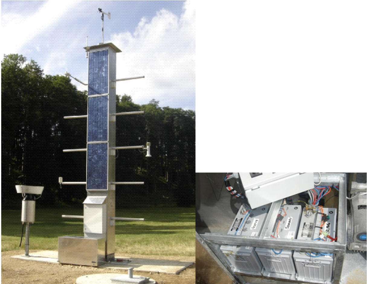
Abbildung 4: li.: Messgerätelift am Trafel (NÖ). re.: Akkumulatoren und Motorgehäuse.
