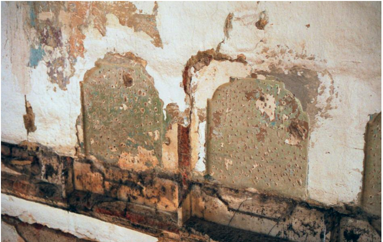
61 Bad Leonfelden, Spitalskirche, freigelegte Emporenbrüstung mit übertünchten Freskenfragmenten, Reste der Auflage des entfernten Zwischenbodens.
