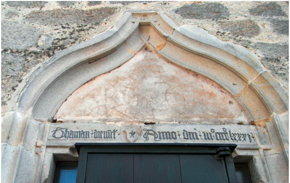
119 Bad Leonfelden, Nordportal, Detail: Eselsrücken über Überlegerbalken mit Inschrift, Überschneidungen am profilierten Gewände, teilweise zerstört; Detail: Meisterzeichen.
