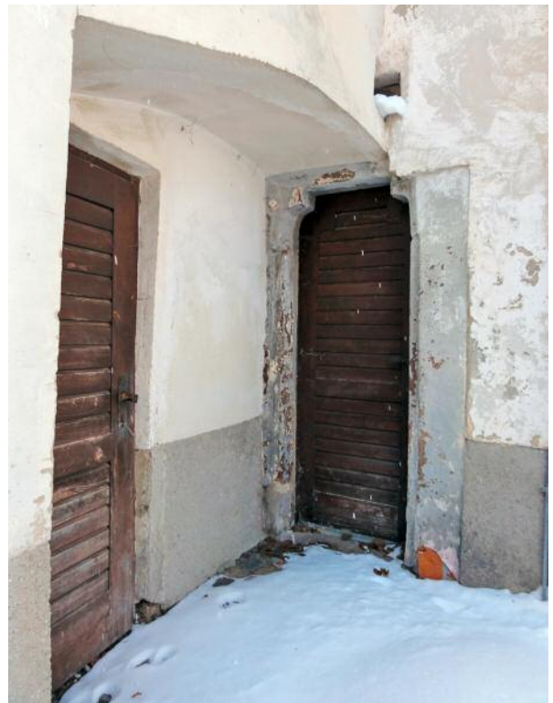
38 Bad Leonfelden, Eingangsbereich zum Bürgerhospital, durch nachträglich hinzugefügten Treppenaufgang verbaut; kleine Sichtluke über dem Portal.
